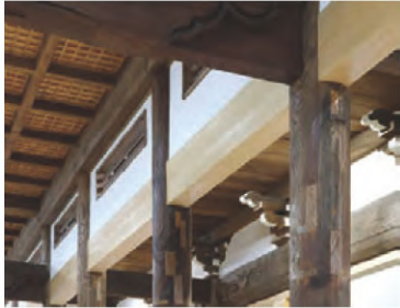
埋め木しながら使い継がれてきた柱に、真新しい梁が交差する。梁を接合する穴、仕口(しぐち)の取り方にも先人の技術力を感じる。
